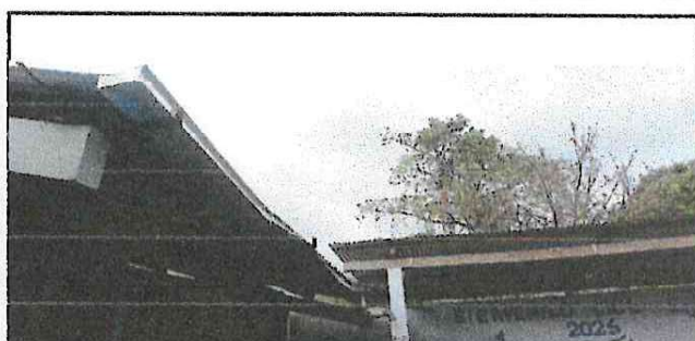
Foto 4: Deterioro de canales metales de baja calidad.
