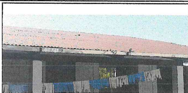
Foto 1: Cambio de lamina por deterioro y oxido en area de corredor
