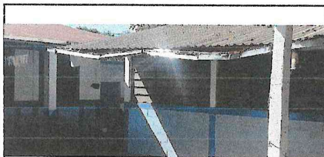
Foto 3: Deterioro de canales metales de baja calidad.
