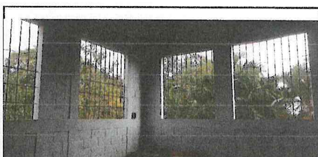
Foto 6: Ventanas de aula a cambiar en lugar de barrotes debido al ingreso de demasiado sol y lluvia
