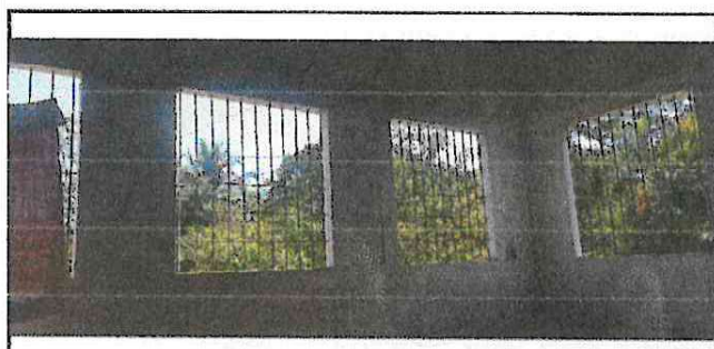
Foto 5: Ventanas de aula a cambiar en lugar de barrotes debido al ingreso de demasiado sol y lluvia
